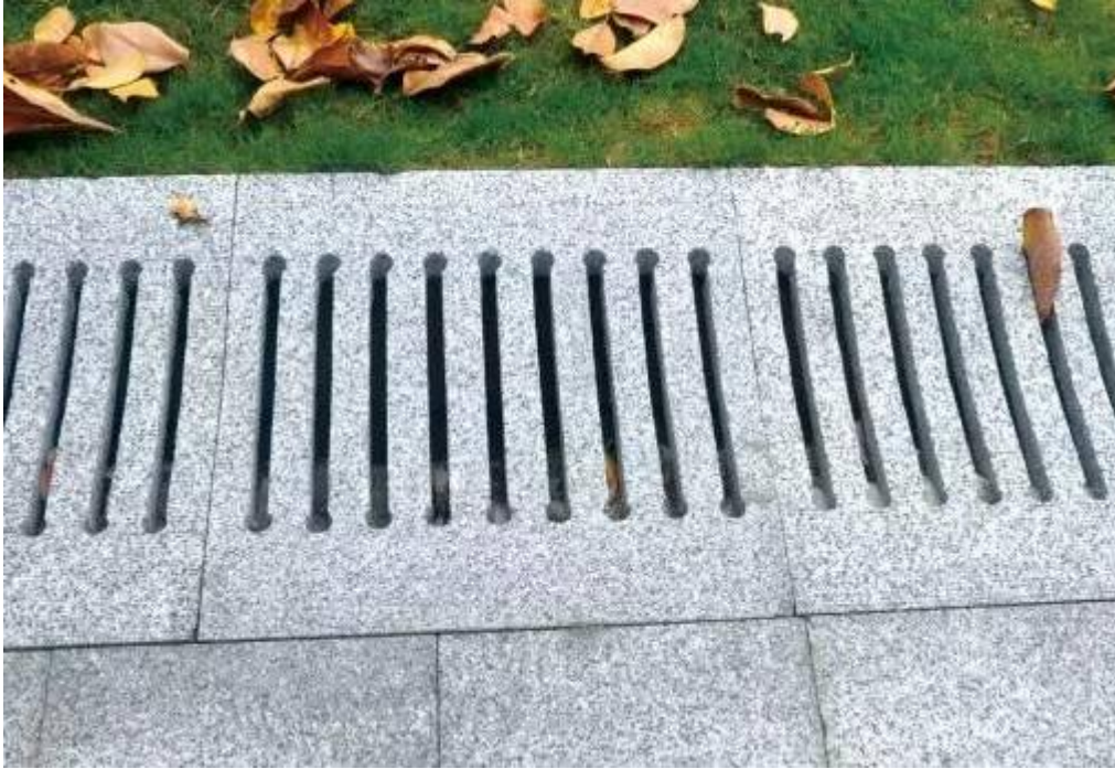
截水沟实景图，选用材料与铺装一致，但铺装对缝不整齐，模数计算不周。
